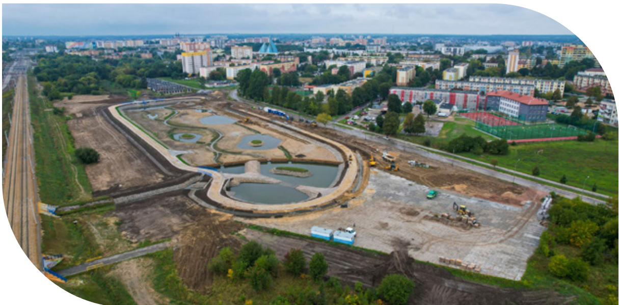
Budowa polderu na Potoku Północnym (fot. Wodociągi Miejskie w Radomiu, Radomski Dron)
