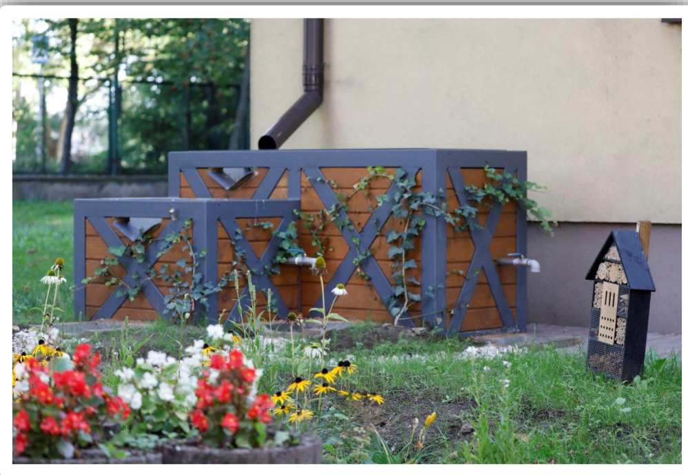
Zdjęcie 13. Zbiornik na deszczówkę na terenie DPS Nad Potokiem. Źródło własne
