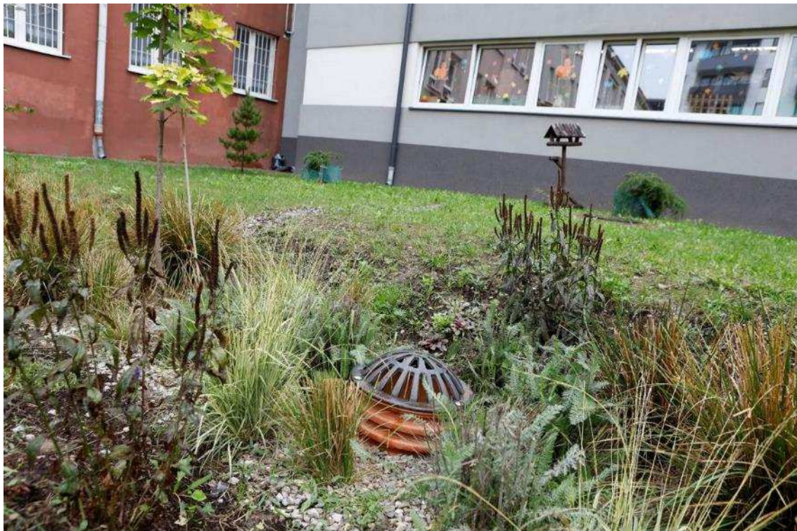
Zdjęcie 13 Stan terenu po Wykonaniu robót - Niecka chłonna ze szpalerem drzew - przelew awaryjny + nasadzenia roślin
