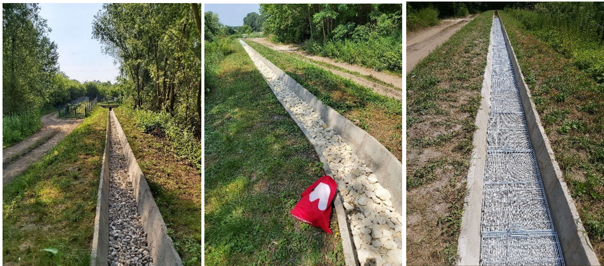
Zdjęcia 7, 8 i 9. Widok na poszczególne bariery filtracyjne (PBR). Od lewej: bariera dolomitowa, wapienna i wypełniona preparatem BioKer w formie stalowych koszy.
