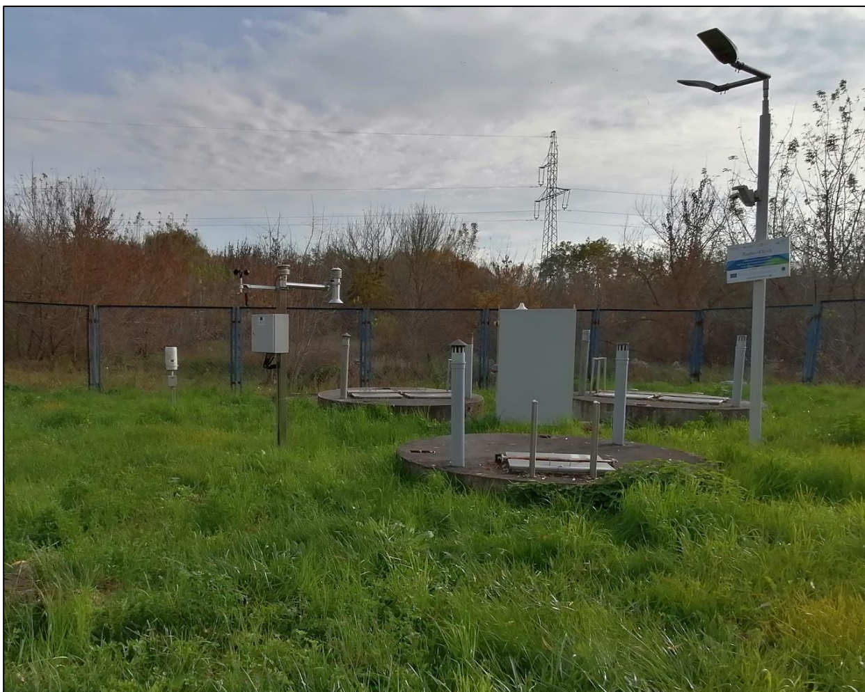
Zdjęcie 3 Widok urządzeń pomiarowych stanowiących stację meteorologiczną ST3
