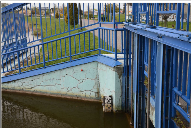
Fot.8. Jaz Borki – łąta wodowskazowa od strony wody górnej. Widoczne zniszczenia betonu (rysy, pęknięcia) (fot. Beata Naglik).
